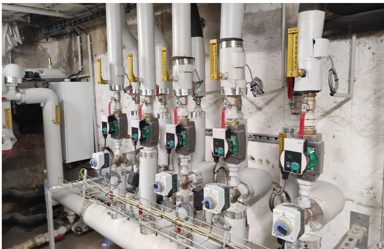
Installation géothermique de Bourguignon - ©ADU
